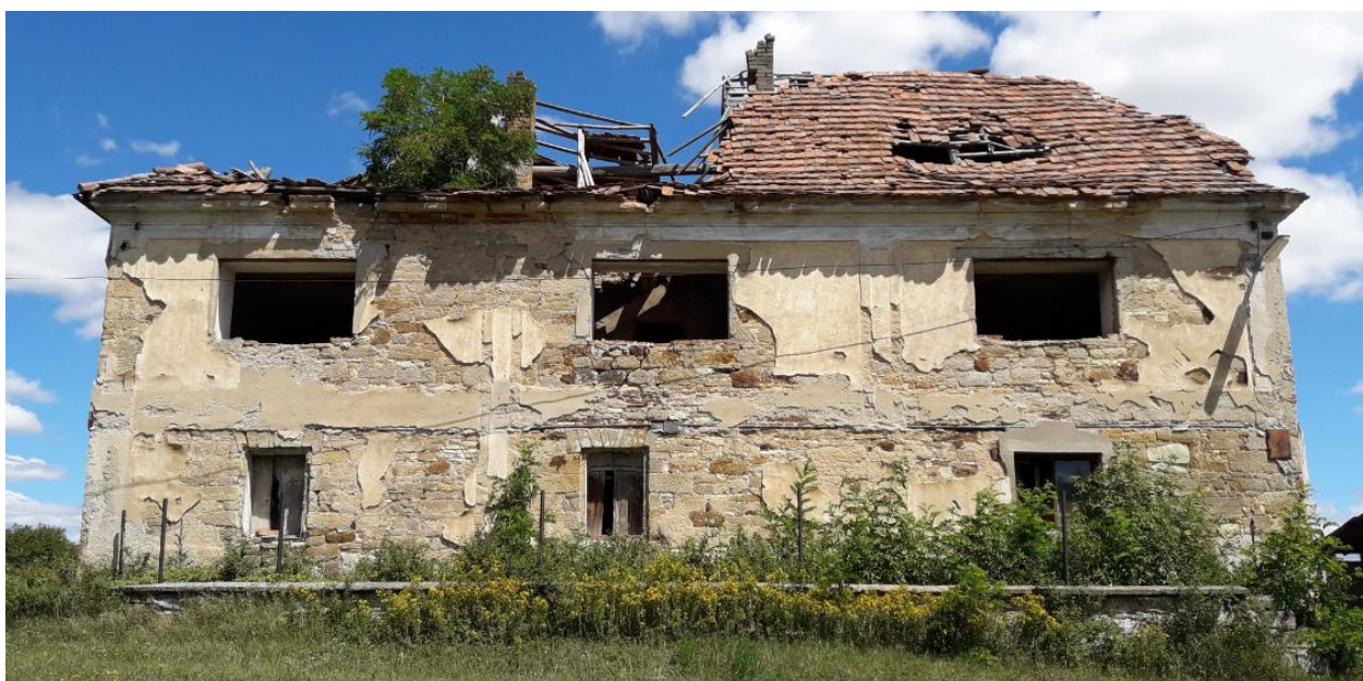
Zbořeniště původní selské usedlosti v severovýchodní části obce Břešťany, které vyžaduje přestavbu.
