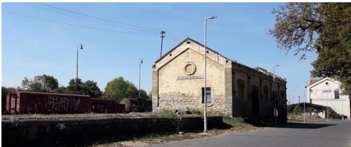
Vlakové nádraží v západní části městyse Zlonice vyžadující obnovu.
